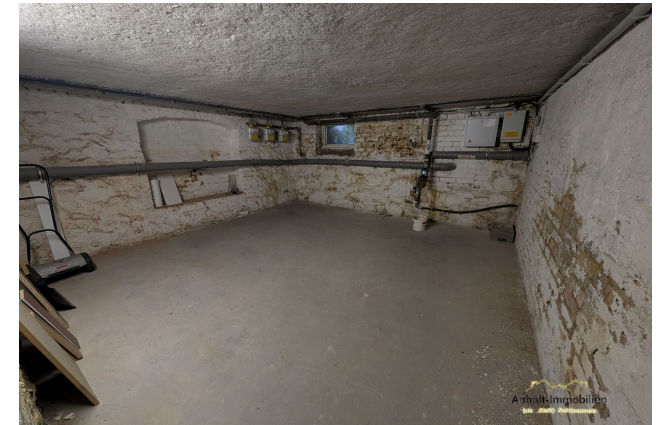
Keller mit Gaszählern
